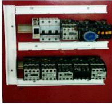
Resim 3.2: Kumanda elemanlarının yerleştirilebileceği raylı pano
